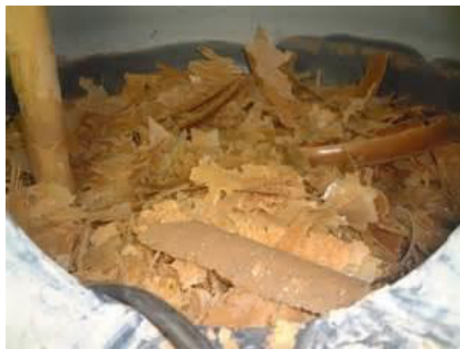
Kalk im Boilersumpf
